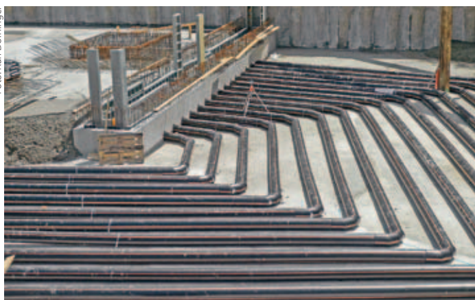
Erdwärmetauscher für die Lüftungsanlage
