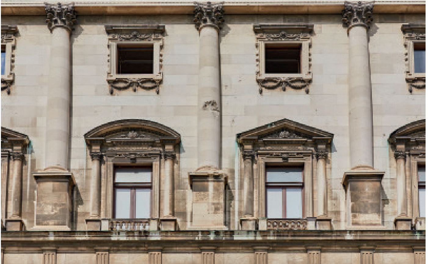
Der noch nicht sanierte östliche Fassadenabschnitt zeigt Verschmutzungen, Fehlstellen und Kriegsschäden.
